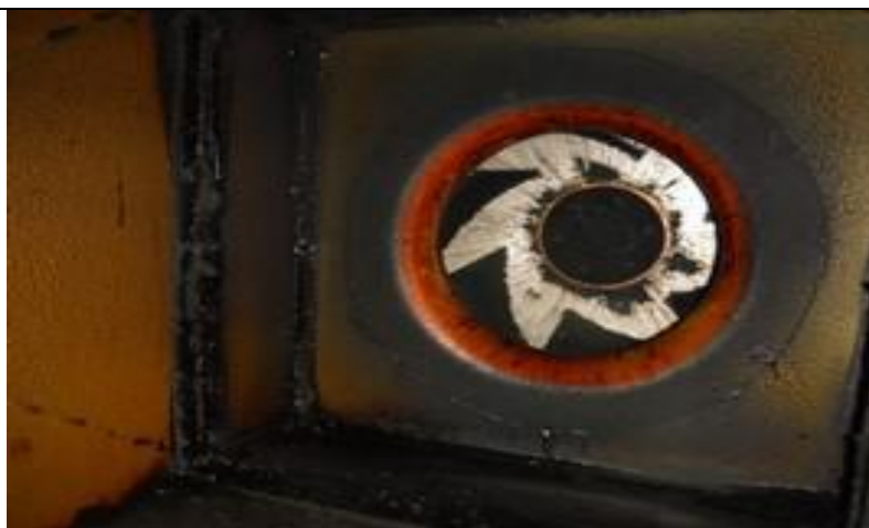
6. Fan Intake before
